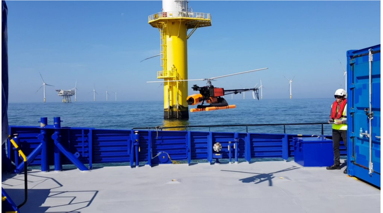
Der AERO-SensorCopter startet zu seinem Wartungsflug an einer Offshore-Anlage. (Credit: Aero Enterprise)
